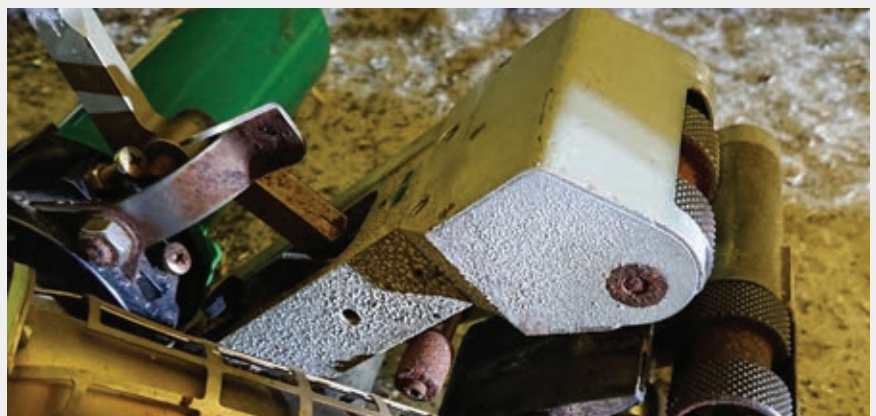
Corrosión causada por la soldadura de PVC
