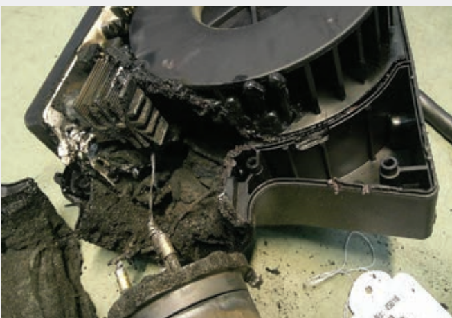
Sobrecalentamiento debido a un diseño incorrecto de la instalación del equipo
