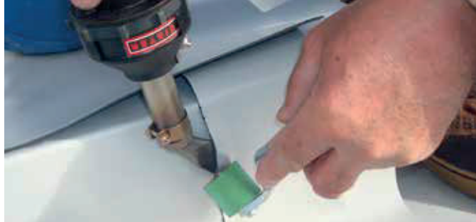
HOT JET S con tobera angulada en soldadura de una unión en T en un tejado.
